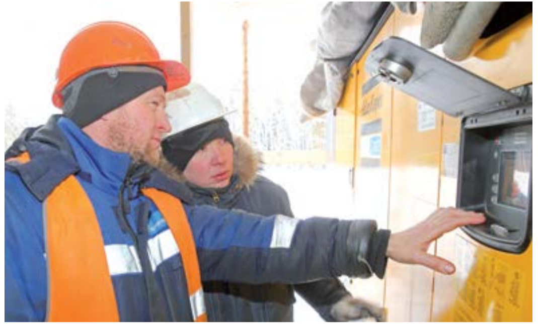
Работа компрессора предварительного нагнетания требует постоянного контроля
