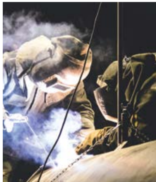
Масштабные работы по капитальному ремонту участка газопровода Парабель – Кузбасс в районе с. Парабель ведутся и в темное время суток
